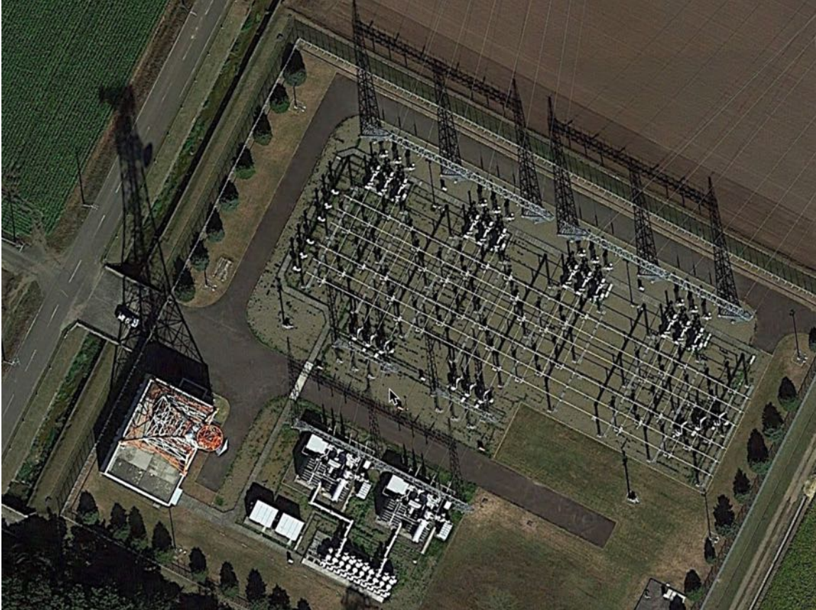
Figure 3-9. Eniwa 187 kV Substation (Latitude 42.9315 Longitude 141.6018)
